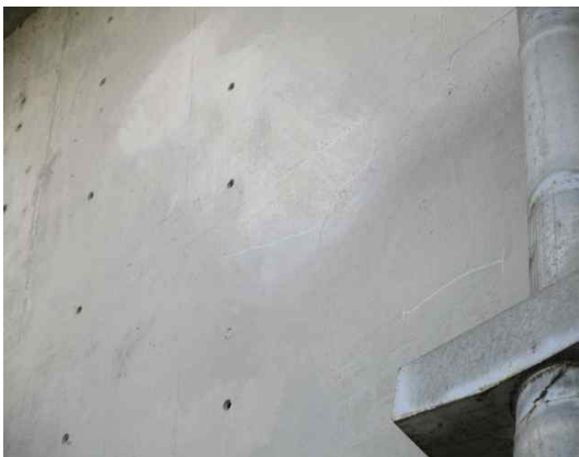
거더외부 좌측면 균열(S2)
