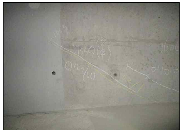
거더내부 우측면 균열(S9)
