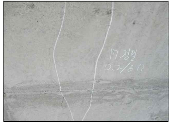
거더외부 하면 균열(S11)
