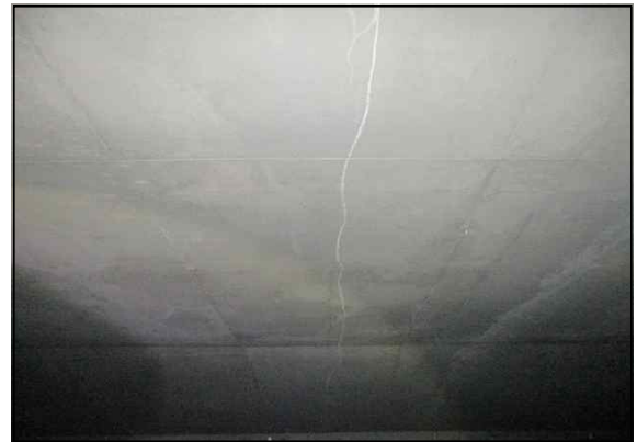
거더 내부 상면 균열(S2)
